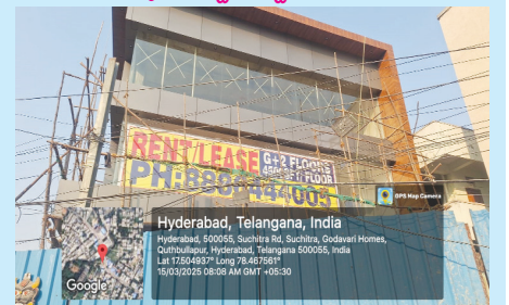
నాలాపై నిర్మించిన అక్రమ నిర్మాణం ఇదే.. అడ్డెక్కు సిద్ధంగా ఉంచారు..
