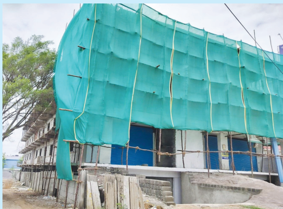
బహదూర్ పల్లిలో కాంగ్రెస్ నేత, మాజీ సర్పంచ్ అక్రమ నిర్మాణం..
