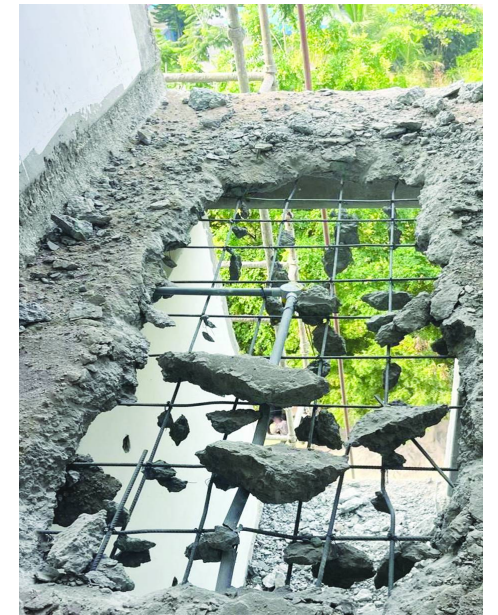
అక్టోబర్ 13న గాగిల్లాపూర్ డ్రీమ్ వన్ లో శివారెడ్డి అక్రమ కట్టడంలో మొక్కుబడి చర్యలు..
